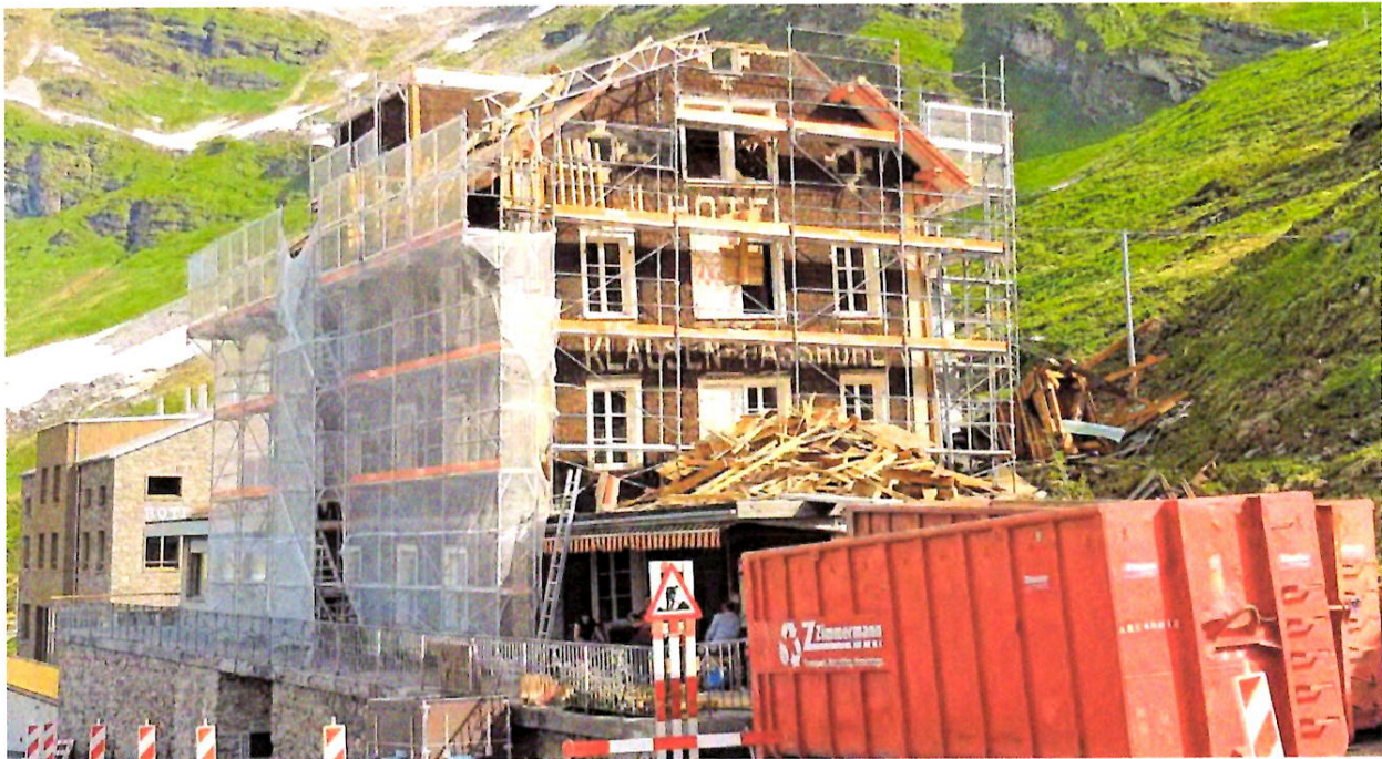
Schrittweiser Rückbau: das alte Hotel ohne seinen markanten Turm und ohne Eternitverkleidung. FOTO: JONAS WYRSCH
